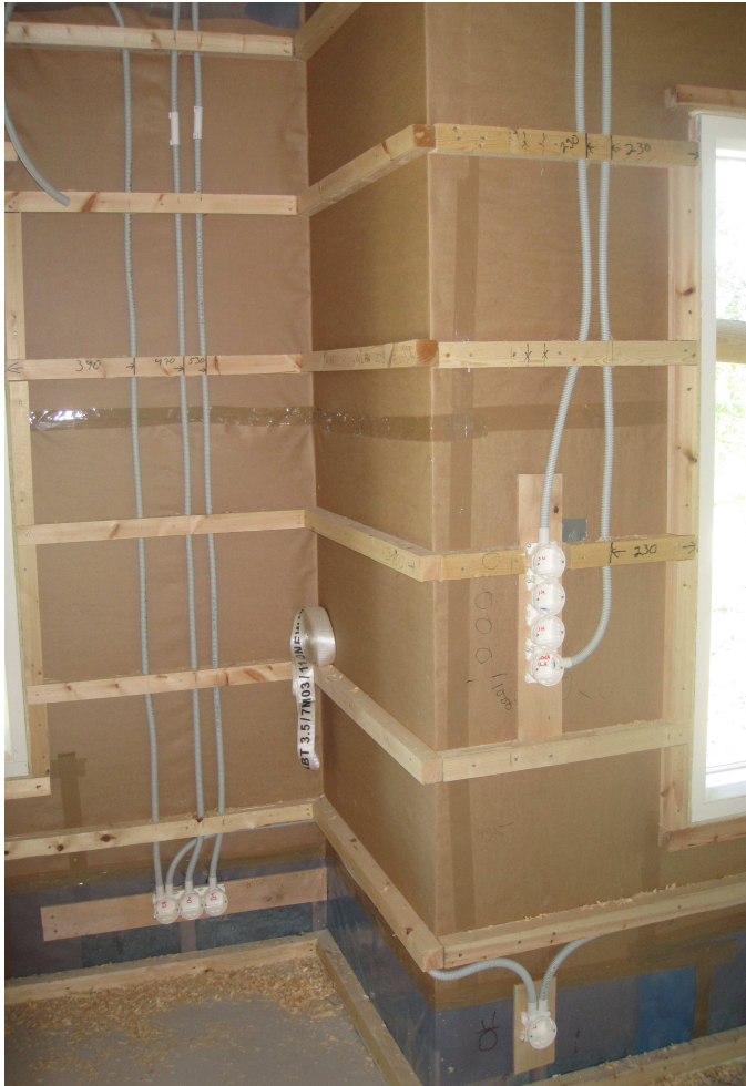
Kytkin- ja pistorasia- ja teleputkituksia
