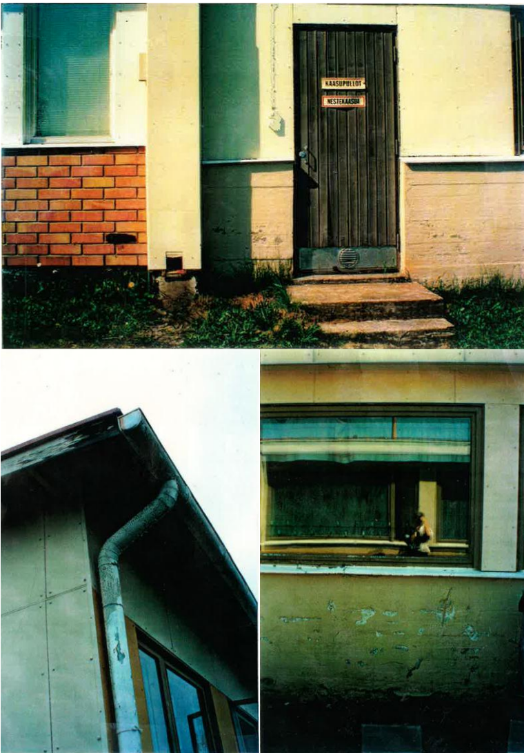
Kuva 7. Varpaisjärven koulukeskus. Kuvia yläasteesta ennen korjausta. (Hankesuunnitelma)
