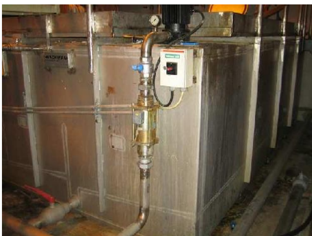
KUVA 4. Säiliö puhtaalle lastuamisnesteelle on tilavuudeltaan 10 m 3
