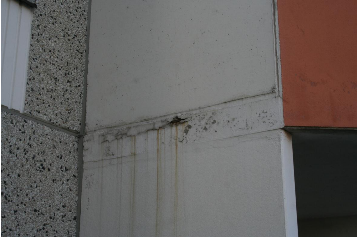
Kuva 23. Laatan reunateräksen teräskorroosioaurio.
