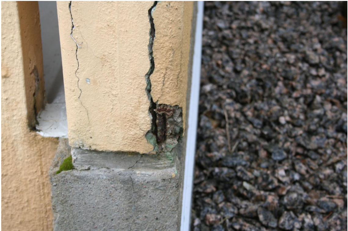
Kuva 5. Teräksen korroosion aiheuttamaa betonipinnoitteen lohkeilua.
