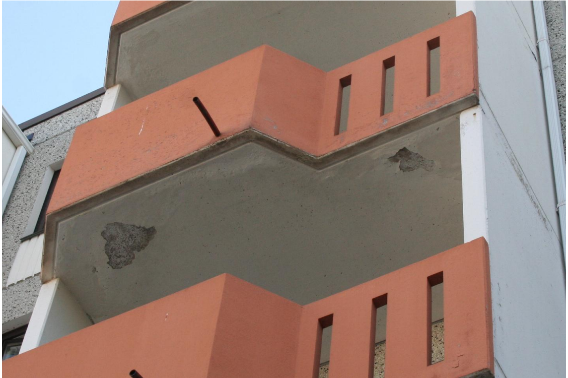
Kuva 22. Betonin rapautumisen aiheuttama pintavaurio
