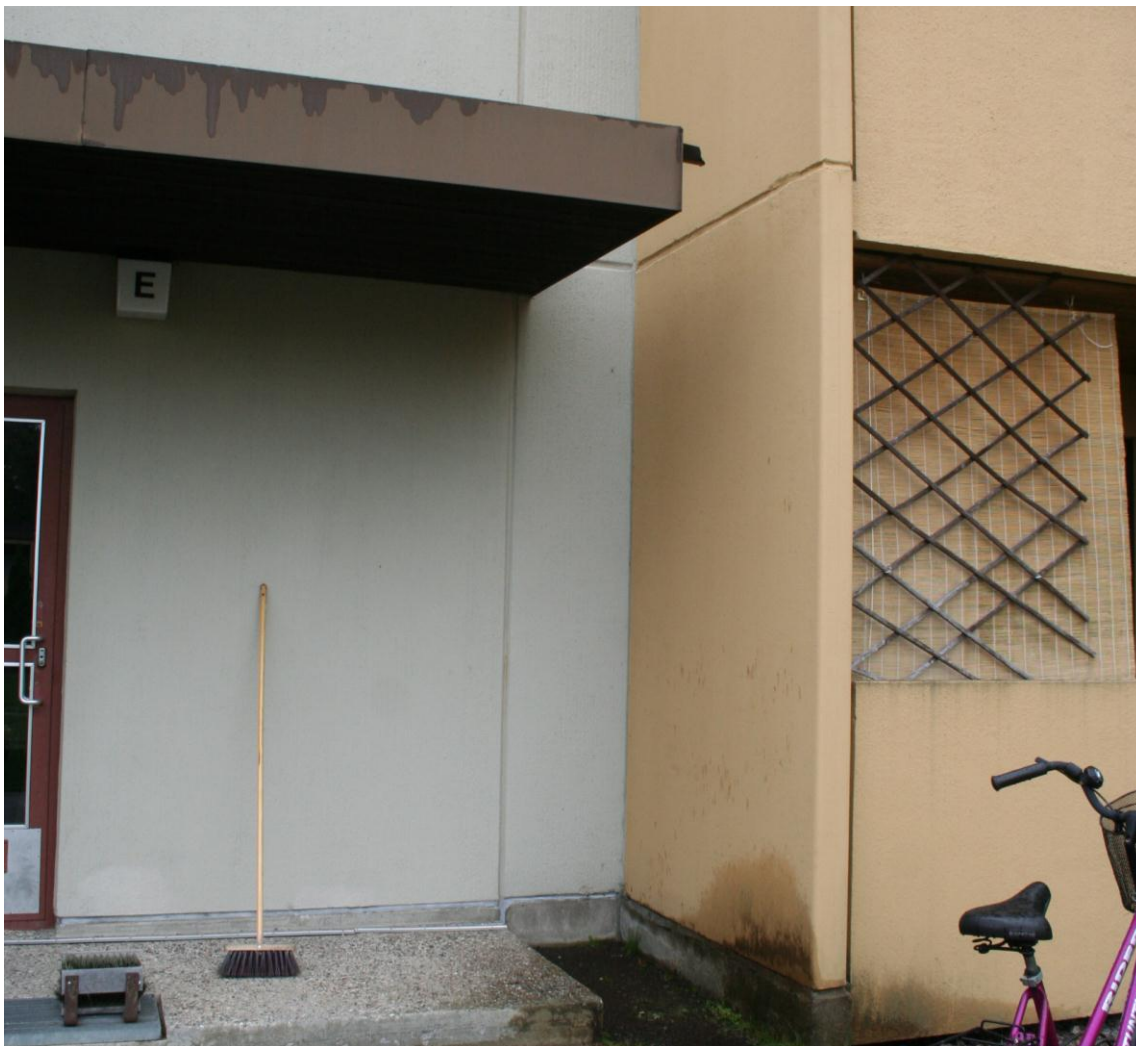
Kuva 11. Esimerkki puutteellisesta vedenohjauksesta, jossa sisäänkäyntilipan vedet ohjataan suoraan parvekepieleeseen
