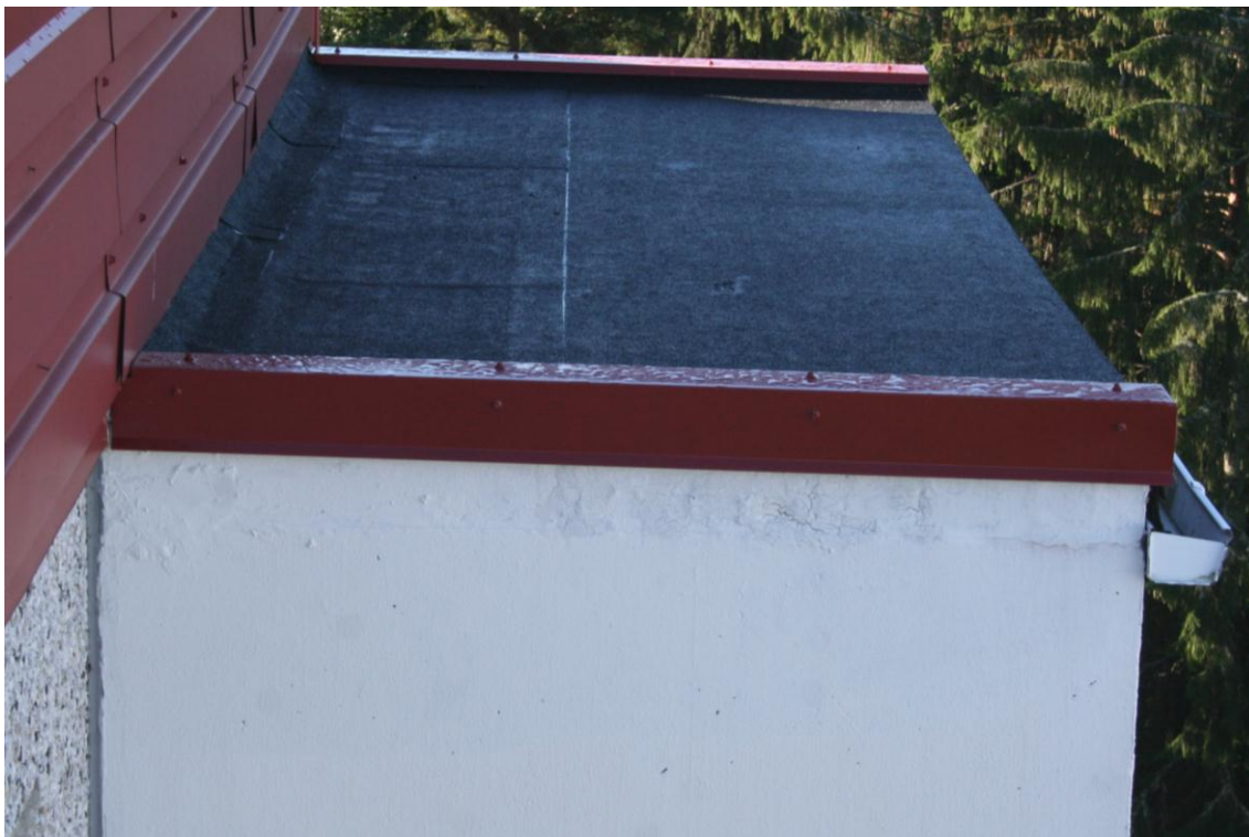
Kuva 10. Kosteusteknisesti toimimaton parvekekaton reuna.
