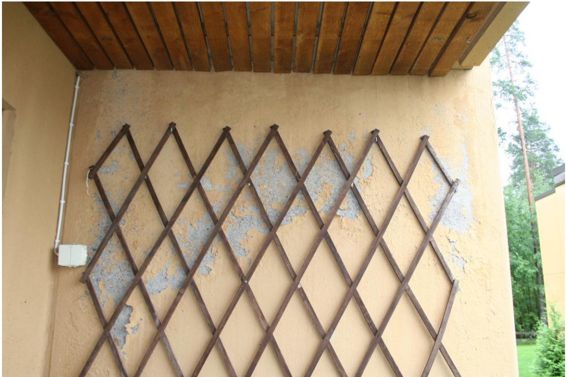
Kuva 8. Betonin rapautumisen aiheuttama pinnoitevaurio.
