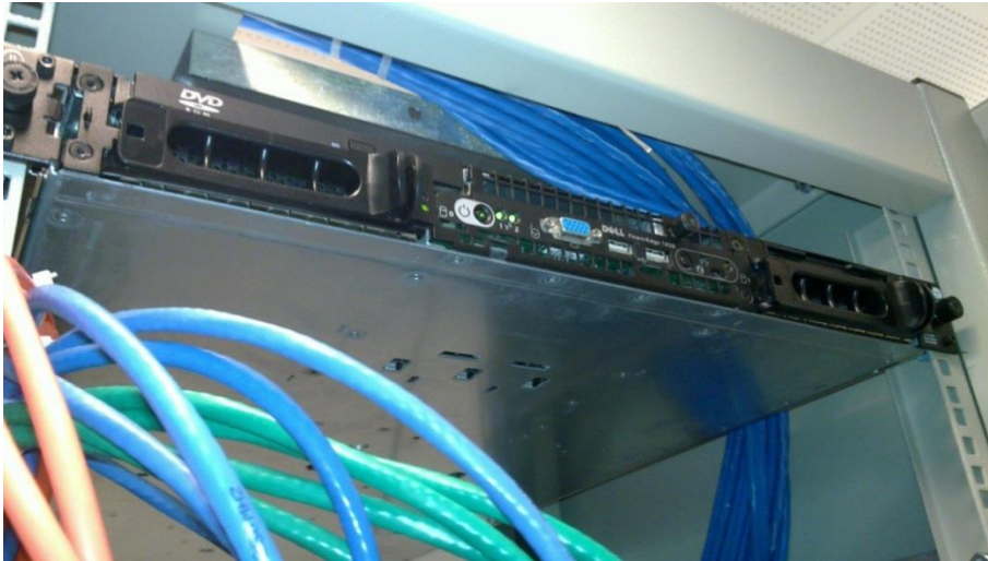
Kuva 11. Dell PowerEdge 1850 palvelinhuoneessa.
