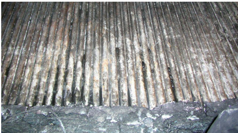
Kuva 26. Soodakattilan pohjaa hyvin suoritettun tankkipesun jälkeen. (7.)
