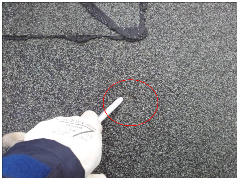
Kuva 17. Lämpökameran osoittama reikä vedeneristeessä. Lämpökamera havaitsi vesikatolla poikkeamat mineraalivillaeristeessä, jotka olivat osittain kastuneet mekaanisista iskuista aiheutuneista rei'istä johtuen.
