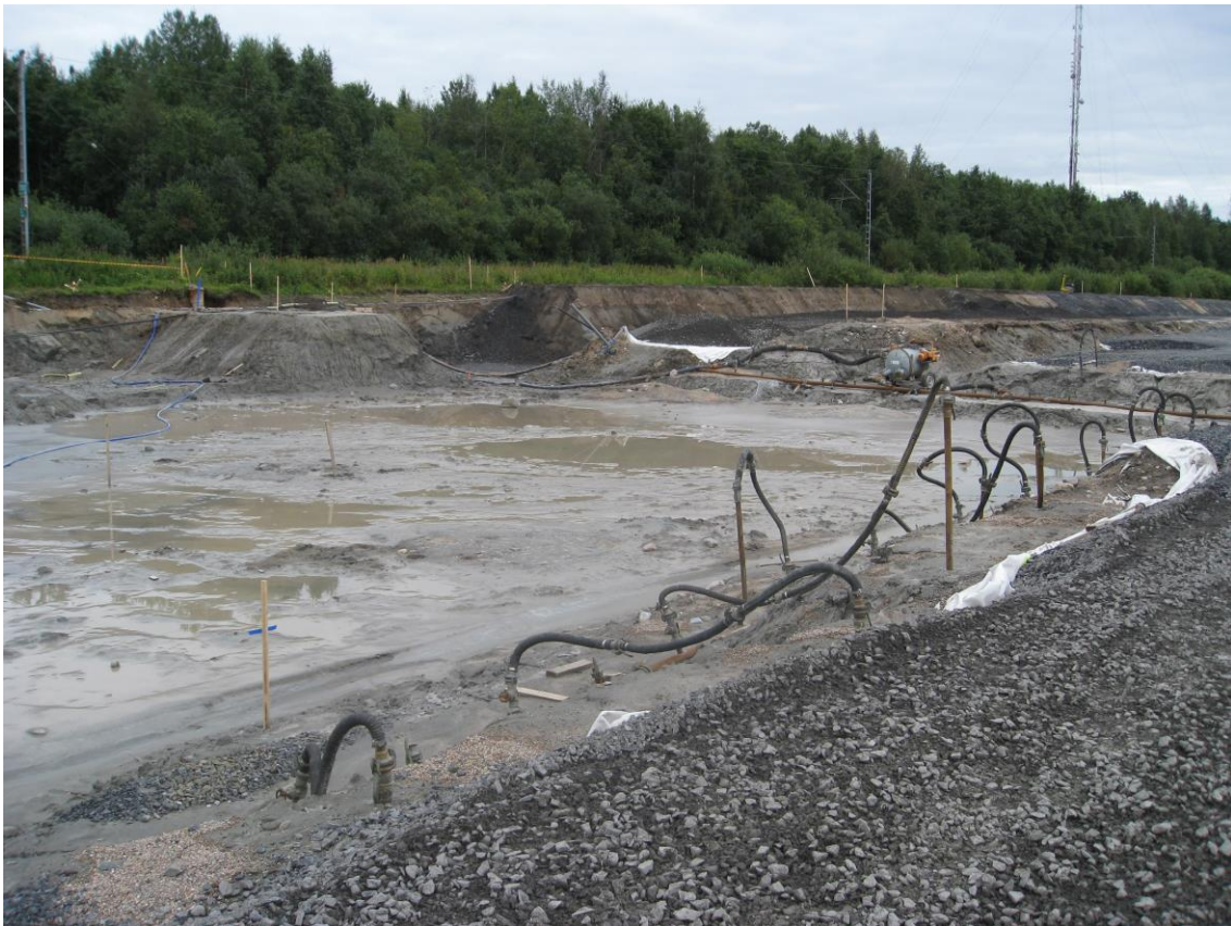
KUVA 5. Imukärkien nousuputket liitettynä runkoputkeen, joka on liitetty imupumppuun
