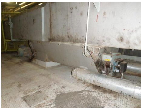
Kuvio 27. Syöttöruuvien kotelo kolakuljettimen alapuolella.
