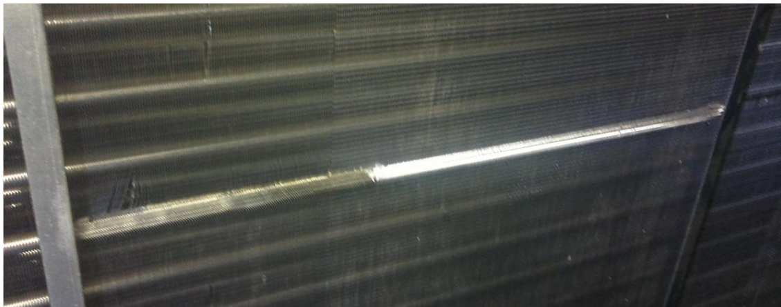
Kuva 22. Lämmityselementti on vaurioitunut asennuksen yhteydessä.
