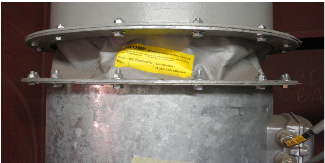
Kuva 20. Puhaltimen joustava liitos.
