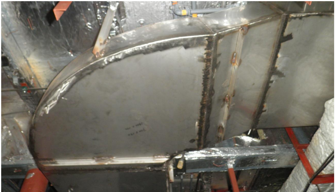
Kuva 17. Paksulevykanavan hitsattu liitos.
