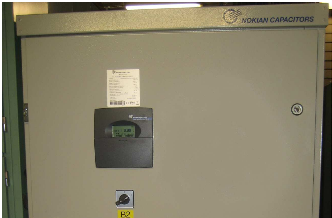
Kuva 6. C-keskuksen kompensointiparisto aktiivisella loistehosäätäjällä (kaapin yläosa).
