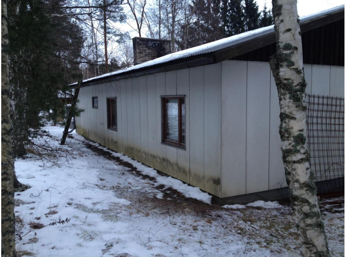
Kuva 9. Pohjoisenpuoleinen julkisivu, jossa nykyinen maanpinta on liian lähellä ulkoseinää ja sadevesi pääsee kastelemaan rakenteita vesikourusta riippumatta.
