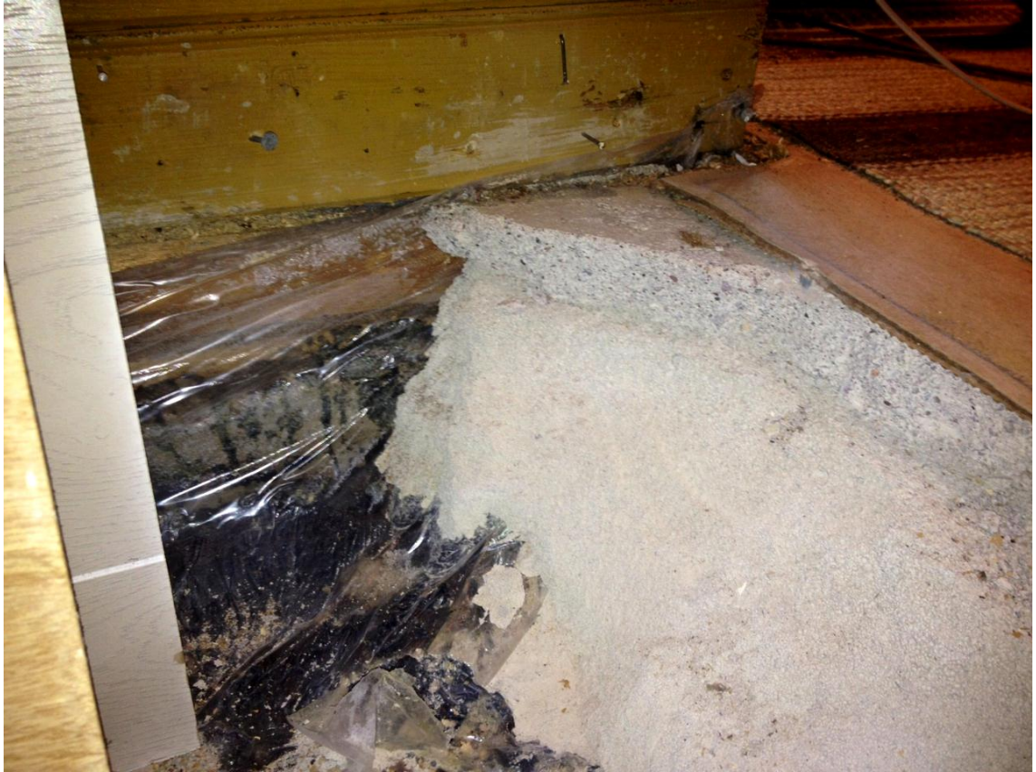
Kuva 5. Kohteen alapohjalaatassa oli bituminen vedeneristyskerros ja eristeenä kevytbetonikerros. Pintalaatta oli vain n. 40 mm paksu.
