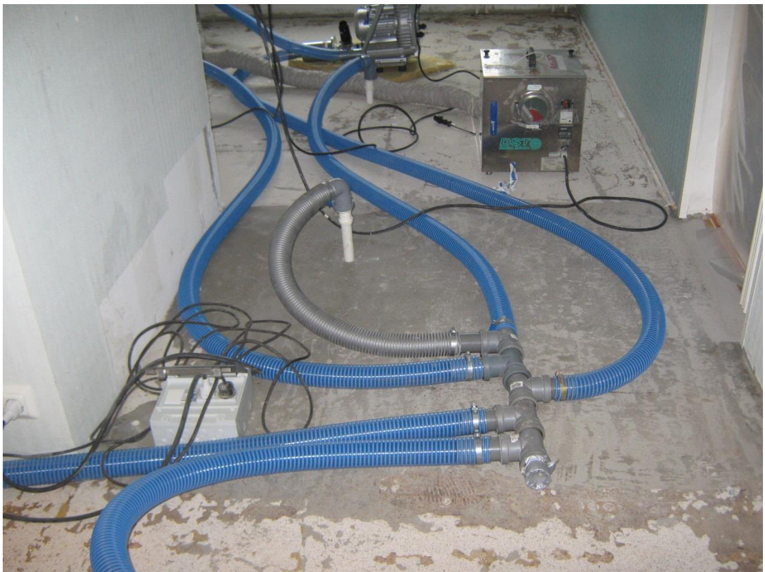
KUVA 9. Eristetilan kuivaus, imupuolen haaroitus
