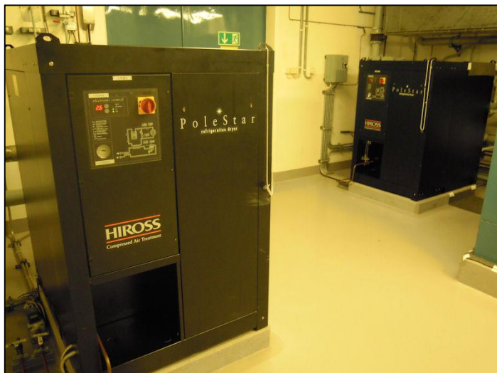
Kuva 7. Kylmäkuivaimet 1.753E3 ja 1.753E4
