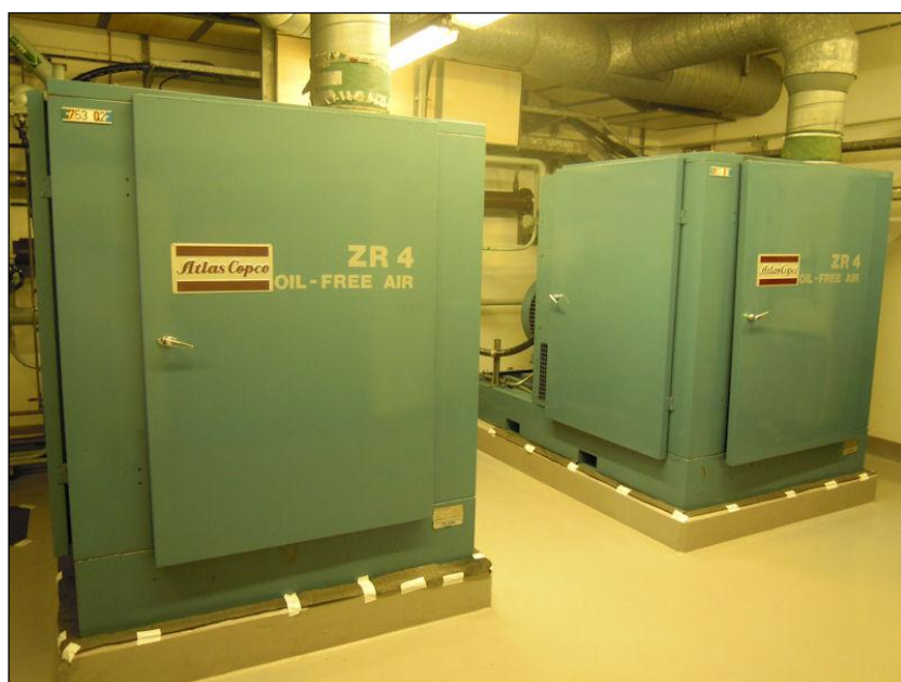
Kuva 5. Olkiluoto 1 -laitoksen Atlas Copco ZR 4 -kompressoriyksiköt
