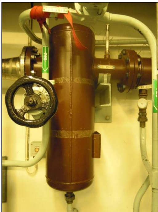
Kuva 8. Paineilman jälkijäähdytin 1.753E5
