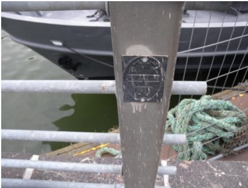
KUVA 37. Katkaistut sillankaiteen johteet
