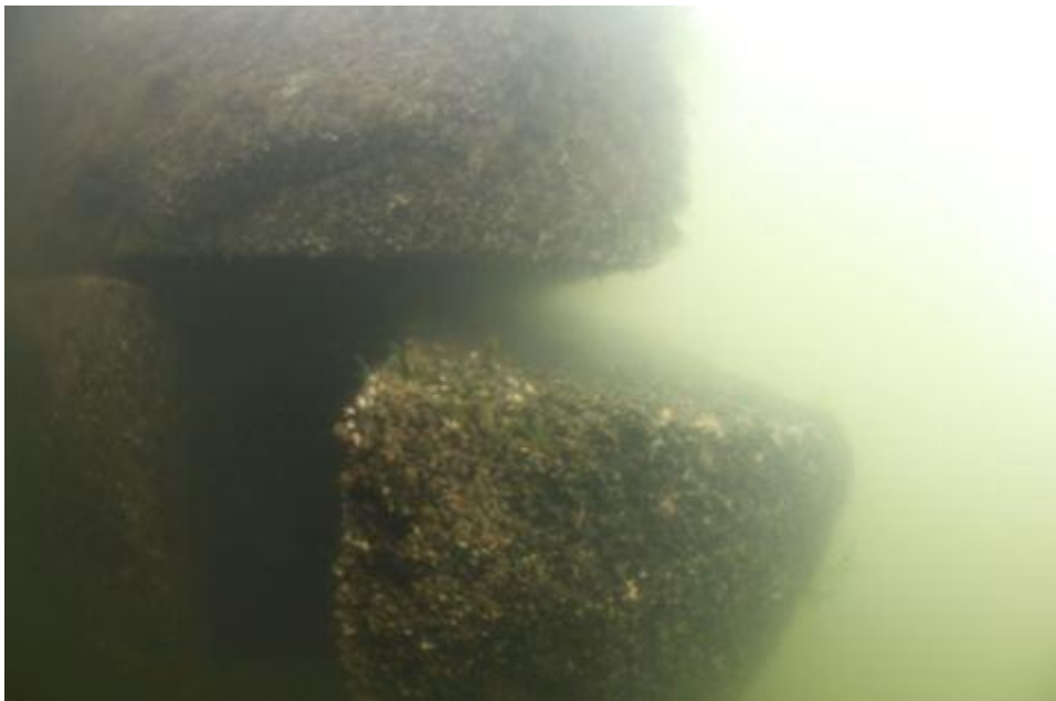
KUVA 29. Välituki, eteläinen puoli, irronnut kivi (Kuva: Tuomas Valli 2012)
