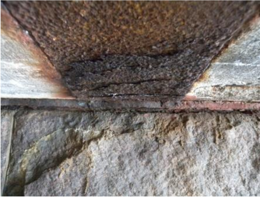
KUVA 21. Teräspalkin korroosiovaurio, teräksen lehteily
