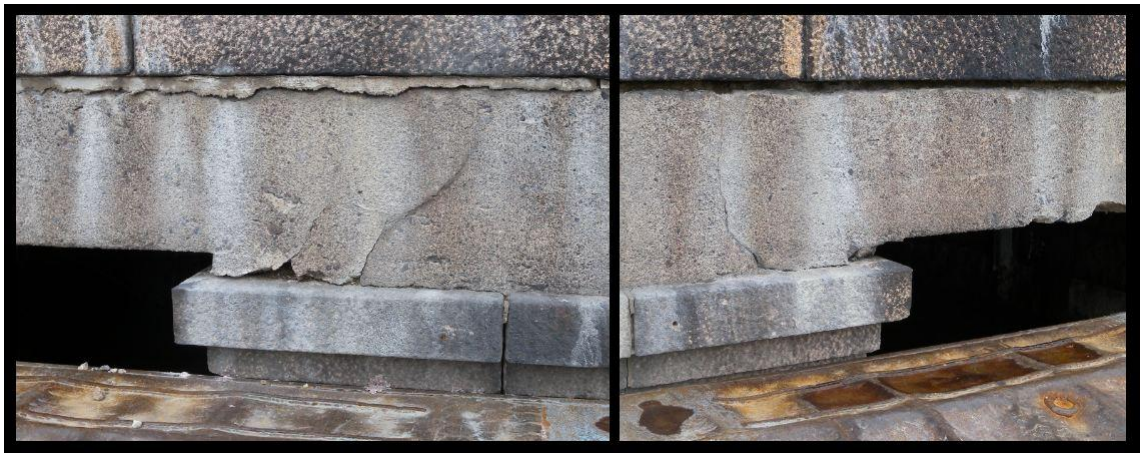
KUVA 17. Kannen sivupinnan halkeamat
