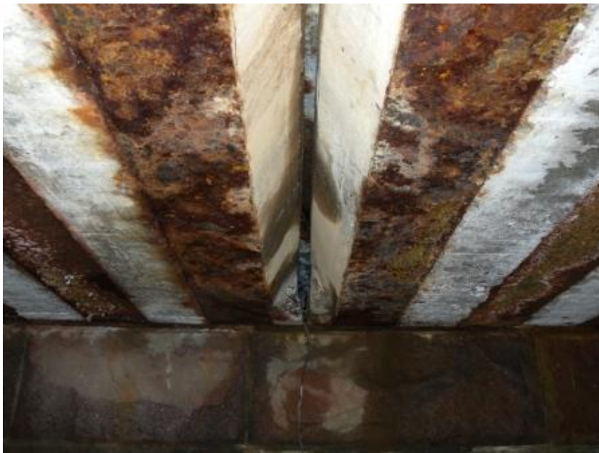
KUVA 15. Kannen alapinnan sauman vesivuoto ja I-palkkien korroosio
