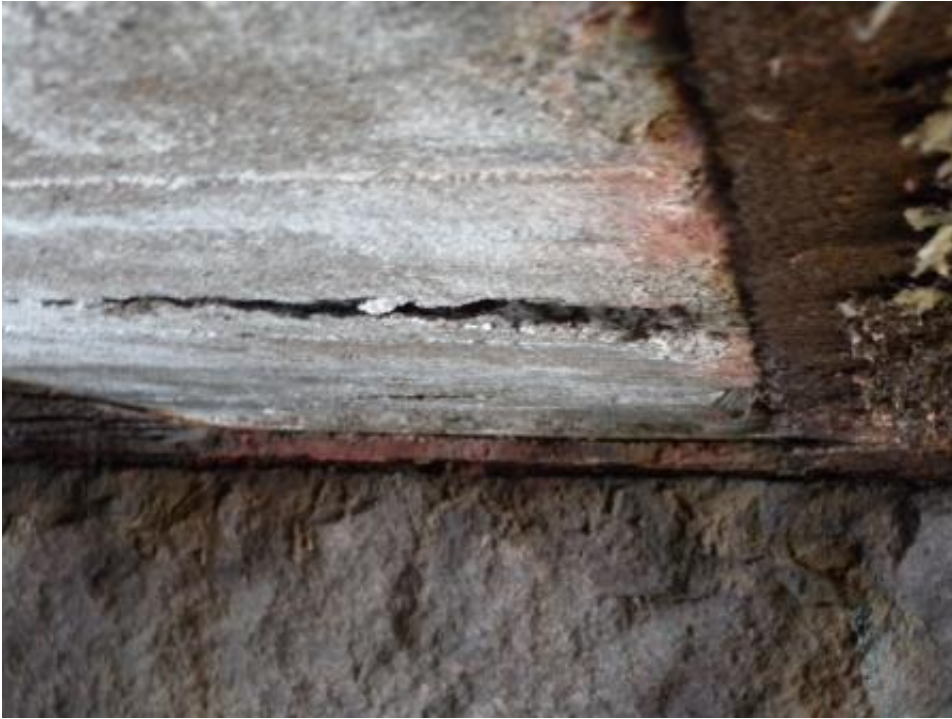
KUVA 18. Kannen alapinnan betonin rapautuminen
