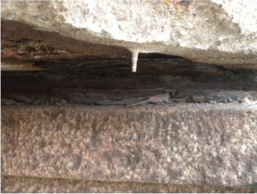
KUVA 41. Maatuen pahoin vaurioitunut liikuntalaite (teräslevyt)
