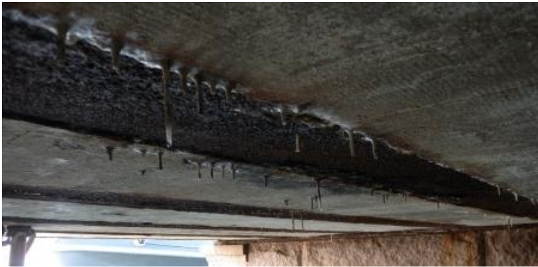
KUVA 16. Kannen alapinnan kalkkivuoto
