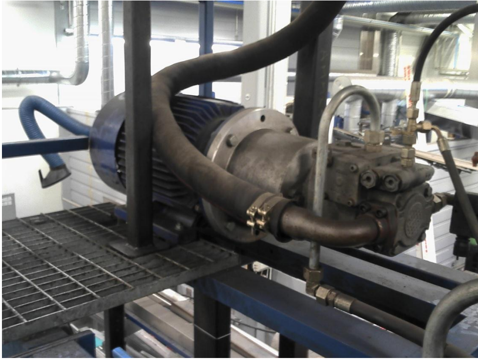
Kuva 16. Pienempi pumpputyksikkö ylätasanteella
