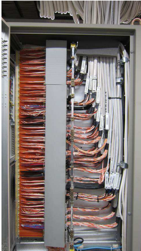
Kuvio 11. Kentältä tulevat kaapelit
