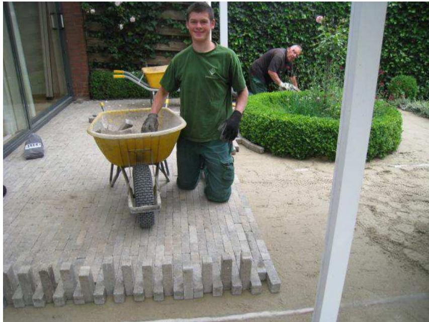
Kuva 15. Klinkkeri-betonitiilikiveyksen asentamista hiekalle tyypillisellä hollantilaisella ladonnalla ohjainkiskojen avulla kiveyksen saneerauskohteessa, jossa vanha kiveys oli niin epätasainen että se purettiin kokonaan ja pohjat tehtiin uusiksi. Kuvassa Ramon Verhoole ja Jan Meyer.
