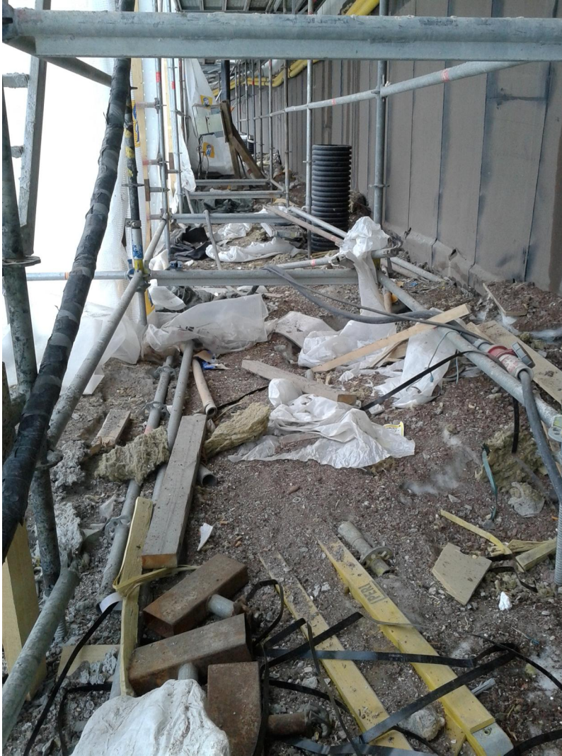
Kuva 1. Ylimääräistä vuokrakalustoa roskien seassa
