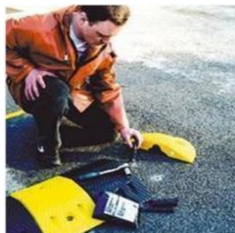
KUVIO 128. Hyvien käyttöominaisuuksien lisäksi hidasteluiskat ovat myös vaivattomia asentaa paikoilleen. (The Manutan Group 2013.)
