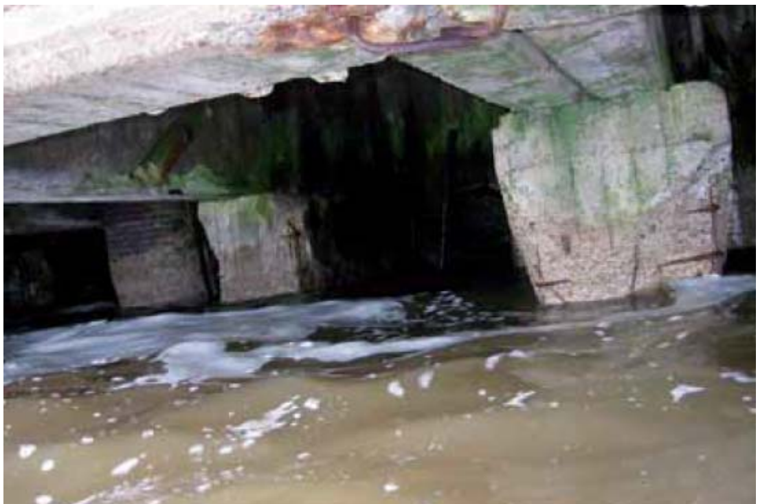
Kuva 1. Vanhempi teräsbetoninen laituri-rakenne, joka on vaurioitunut vesirajasta (Karvonen & Laakso 2012.)
