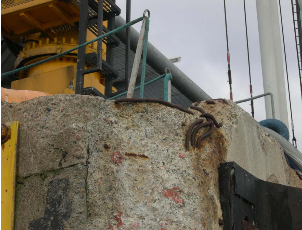
Kuva 12. Betonin lohkeilua, rapautumaa ja terästen korroosiota, jota ilmenee laiturin reunamuurissa.
