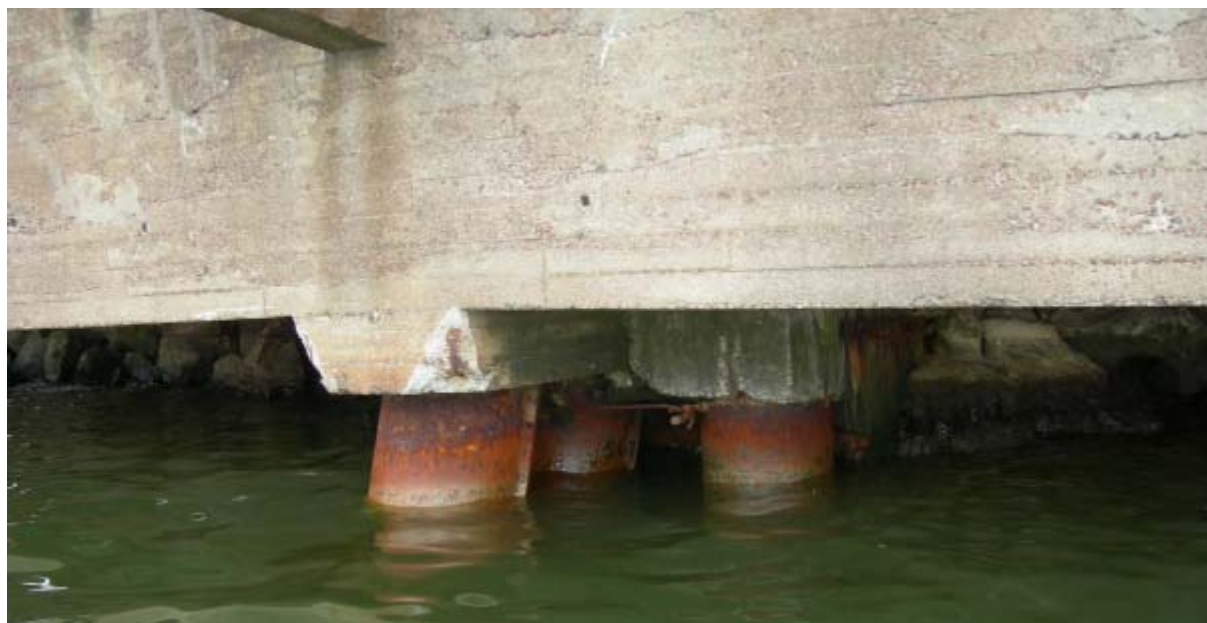
Kuva 14. Teräspaalujen korroosiota vesirajassa (Karvonen 2013)
