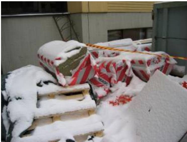
Kuva 8. Työmaalla väärin varastoidut lämmöneristeet ovat kastuneet puutteellisen suojauksen seurauksena (Rakennustarvikkeiden säilytys, kosteuden hallinta ja työturvallisuus 2008)
