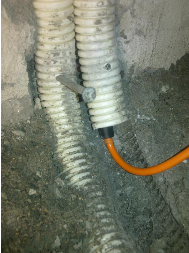
Kuva 17. Huolimaton työntekijä oli lävistänyt naulalla lämmitysputket.
