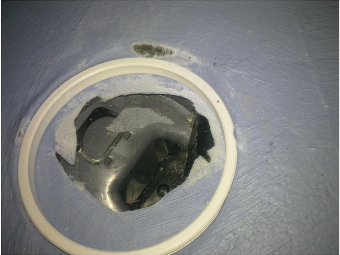
Kuva 4. Kuvassa näkyy lattiakaivon kiristysrenkaan virheellinen asennus.
