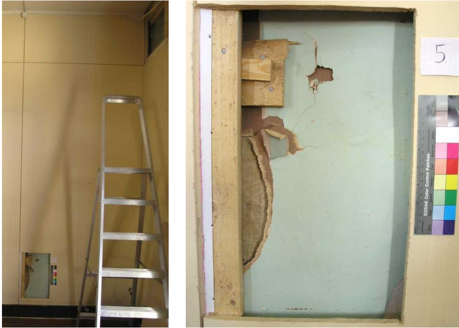
Kuvat 26 ja 27. Seinän esiinottoaukko 5 ja aukon sijainti. (Kuvat: Jenni Jokinen.)
