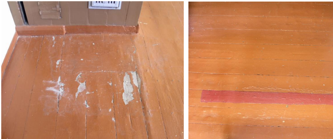
Kuvat 35 ja 36. Kuva lattiasta hella vierestä ja vanhan väliseinän kohdalta.
