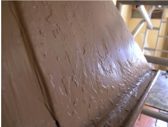
Kuva 39. Huuvan maalipintaa. (Kuva: Jenni Jokinen.)
