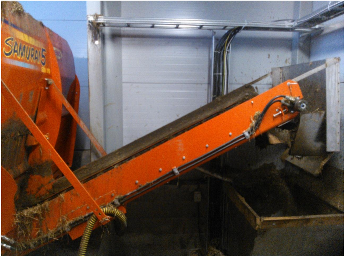
Kuva 6. Kuivasyöte kulkeutuu elevaattoria pitkin ja putoaa sen yläpäästä syöttöruuvien suppiloon.
