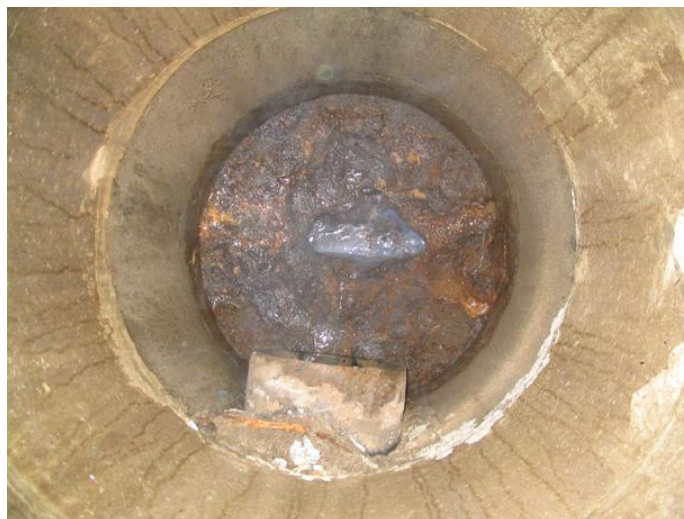
Kuva 4. Pohjastaan vuotava jätevesikaivo Nuolenkujalla.
