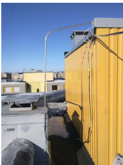
Kuva 34. JAPP-putki kanavan ja kopin katon välillä
