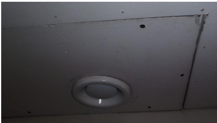
Kuva 15. Kuitusementtilevy yhteistilojen ilmanvaihtoventtiilin yhteydessä
