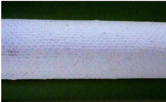
Kuva 9. Putkieristeen maalattu päällystekangas
