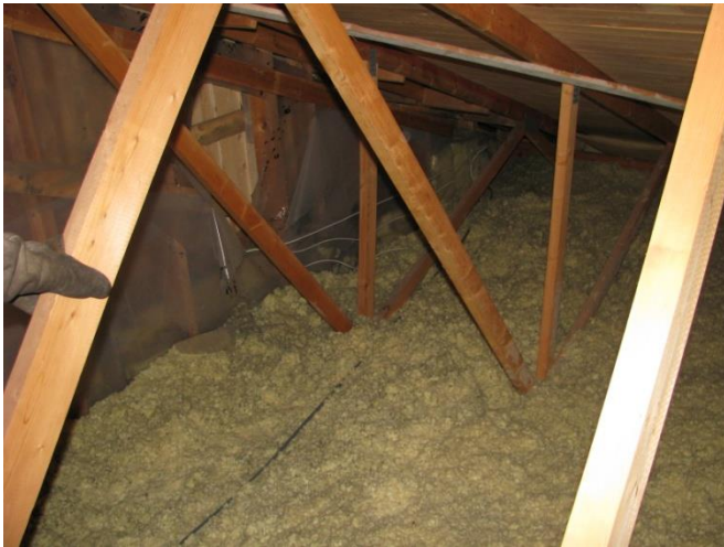
KUVA 2. Yläpohjan puhallusvillaeristys on osittain painunut ja kasaantunut
