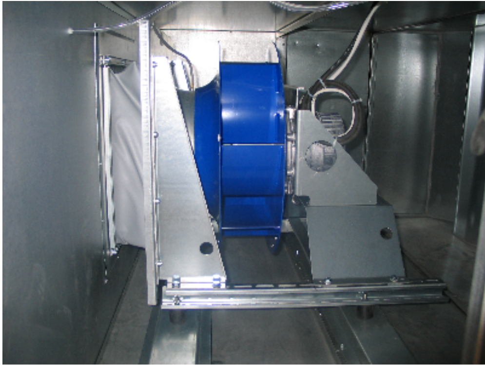
Kuva 9. EC-puhallinkokonaisuus, uusi poistokone
