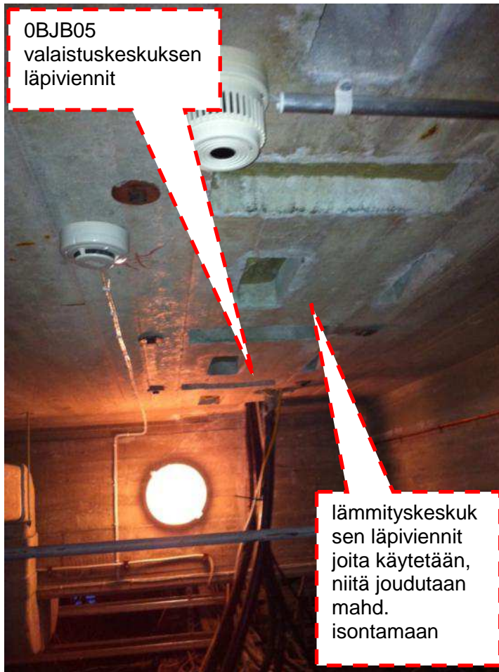
Kuva 10. Läpiviennit kaapelitilasta uudelle keskukselle
