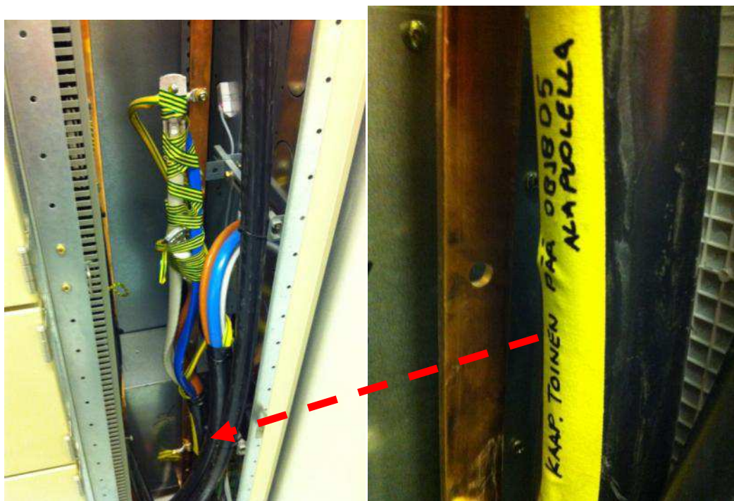
Kuva 7. Syöttökaapeli, keskuksen 0BFA kaapelitilassa sekä kenno 03D
