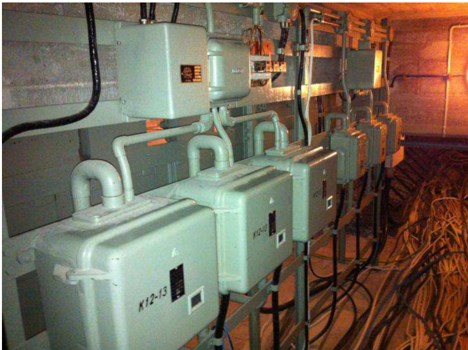
Kuva 3. Nykyinen lämmityskeskus ohjauspuoli
