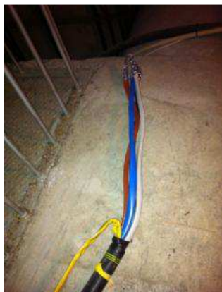
Kuva 9. Kaapelin toinen pää, kaapelitilassa valvomon alla uudenkeskuksen alapuolella
