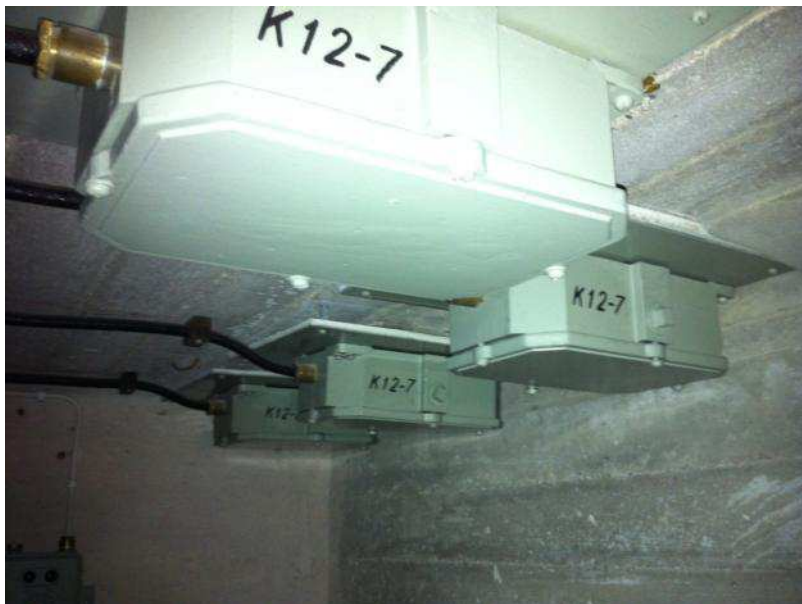
Kuva 26. Lattialämmityksien liitäntärasiat, vanhan keskuksen vieressä
