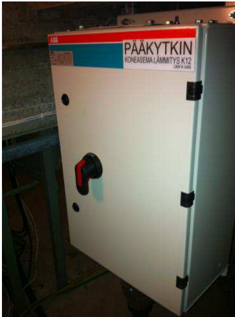
Kuva 4. Nykyinen pääkytkin keskukselle
