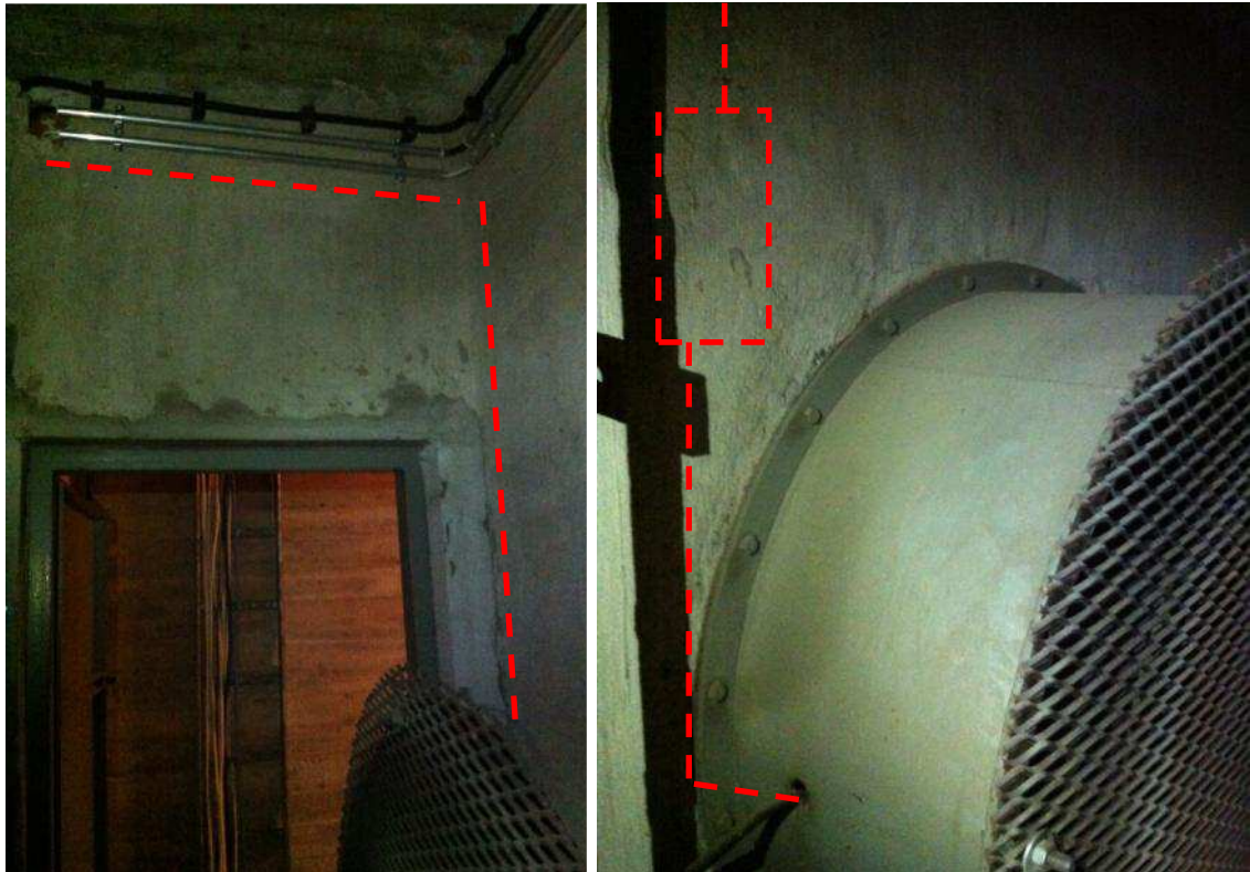
Kuva 23. Puhallinkanava ja turvakytkimen paikka
