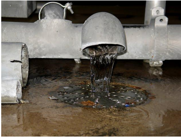
KUVA 18 Laatikkopesukoneen (LPK1) pesuveden poisto suoraan lattiakaivon päälle
