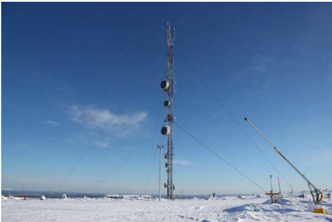
Kuva 15. Antennimasto Levi-tunturin huipulla
