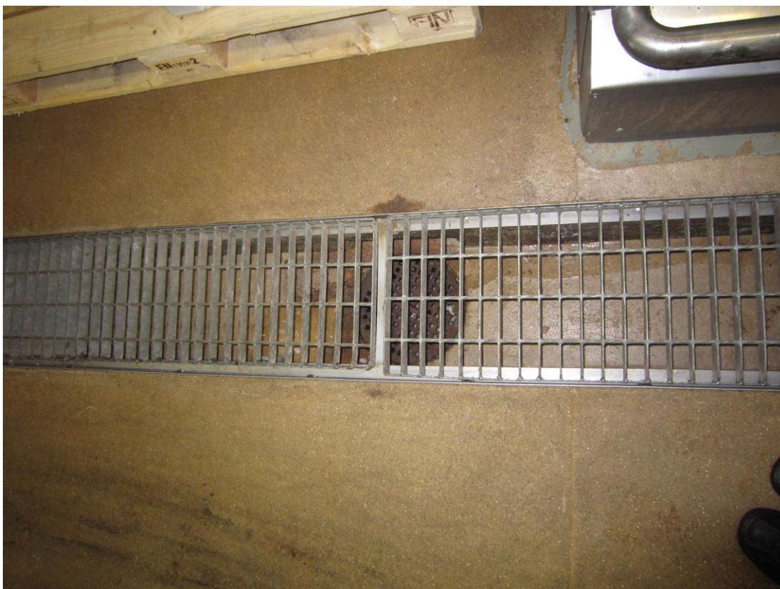
Kuva 6. Lihajaloste Korpelan jätevesikourun ritilä./2/
