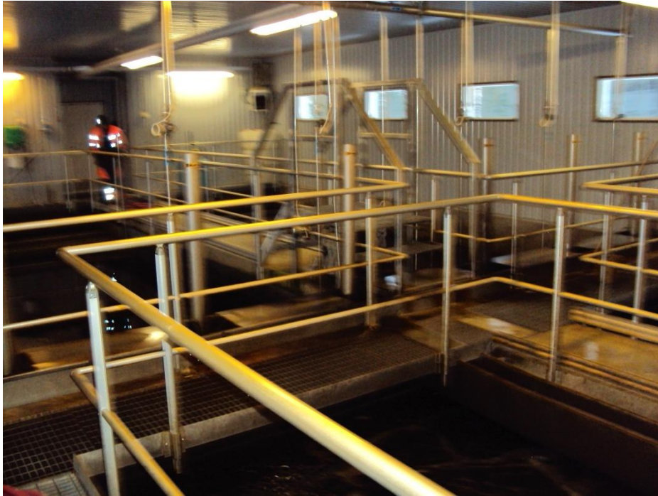
KUVA 7. Jätevedenpuhdistamon käsittelyaltaita (Kosunen 2013).
