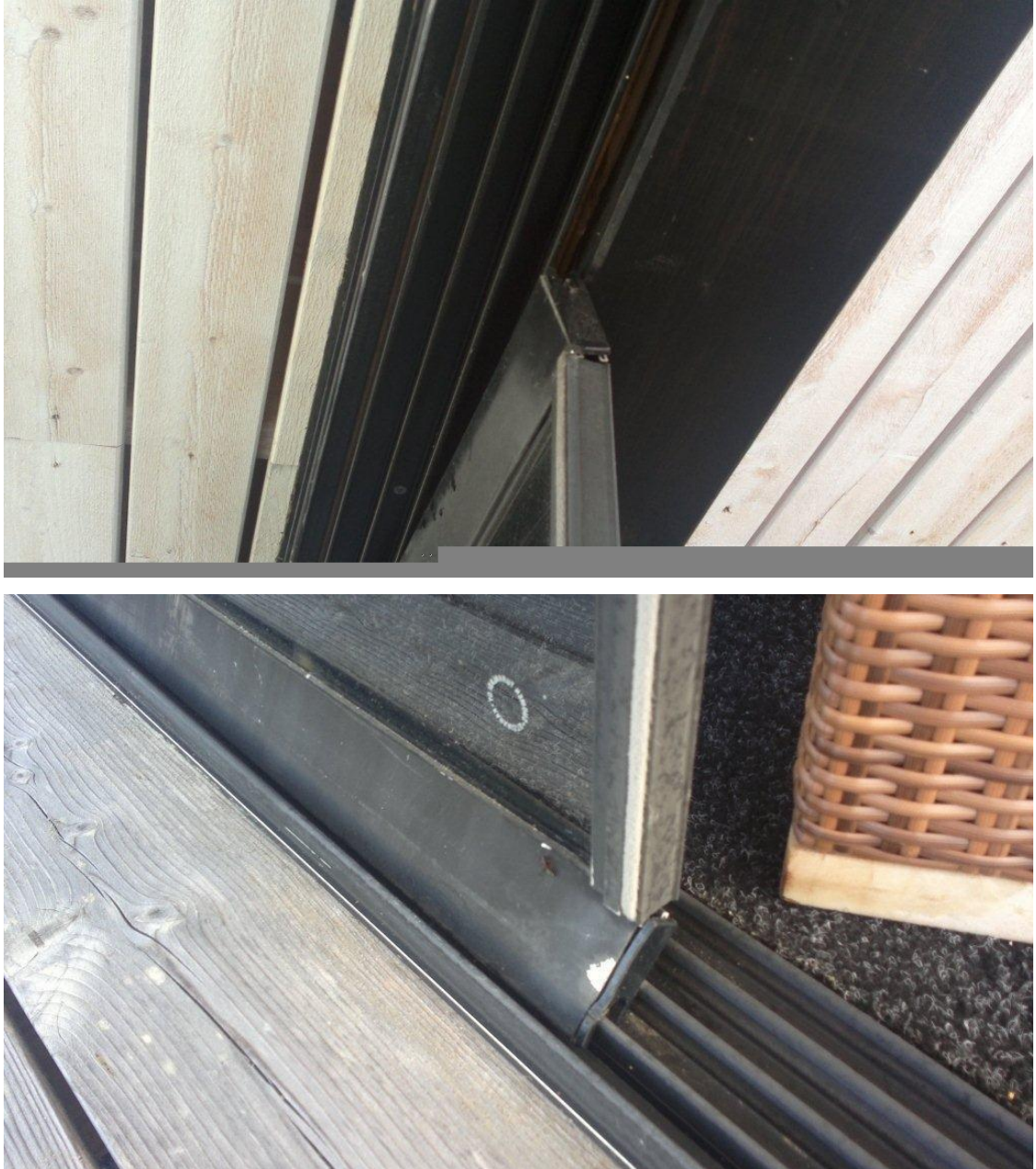
Bild 14. Skjuddörrarnas karmar har vridits av hård storm. (Karlsson 2013)
