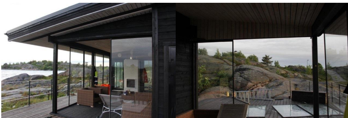
Bild 13. Skjutdörrar förstörda av stormen. (Karlsson 2013)
