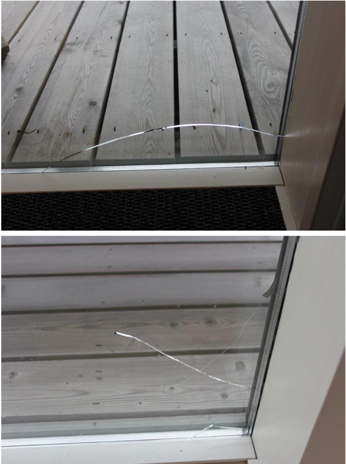
Bild 15. Sprickbildning i fönstren på grund av hård storm. (Karlsson 2013)
