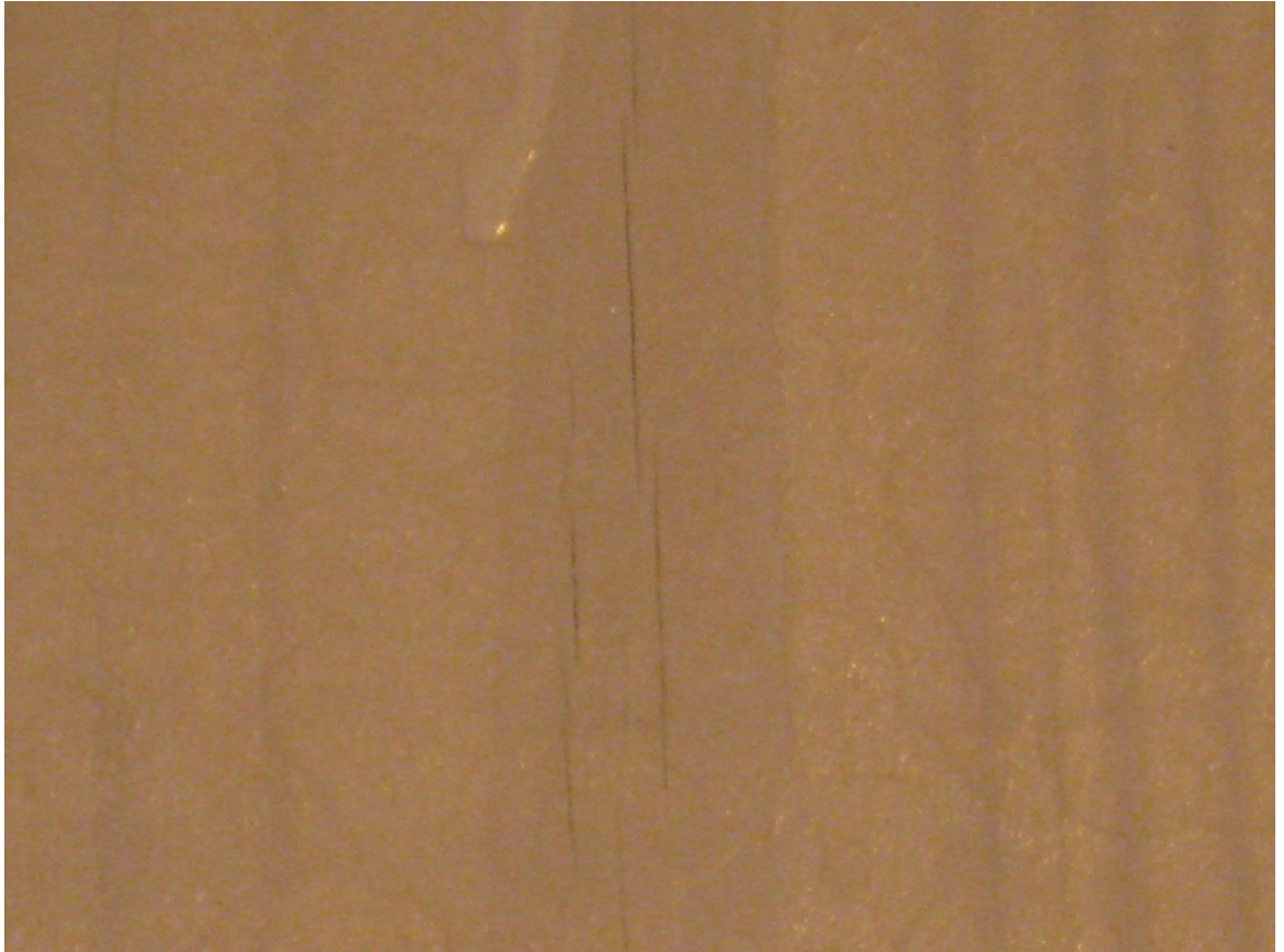
Kuvio 25. Testin loppuvaiheessa näkyviin tulleet hiushalkeamat.
