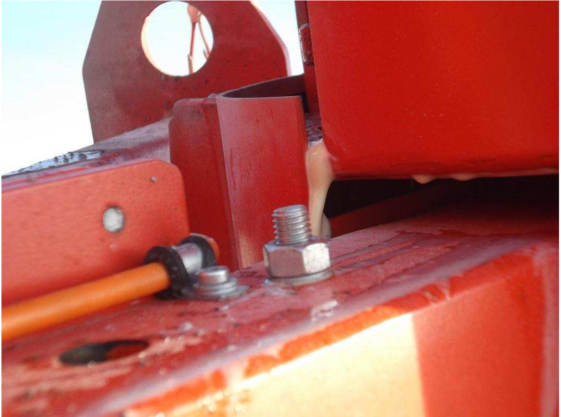
KUVA 5. Näkyvissä sähköjohdon kiinnityslenkki nykyisellä paikallaan, kotelon tukijalan läpi tulevan pultin pää sekä yksi kotelon ongelmakohdista, jossa välipohjan päältä valuu öljyä kotelon ulkopuolelle (Kuva: Sandvik, Uwe Vetter 2012).
