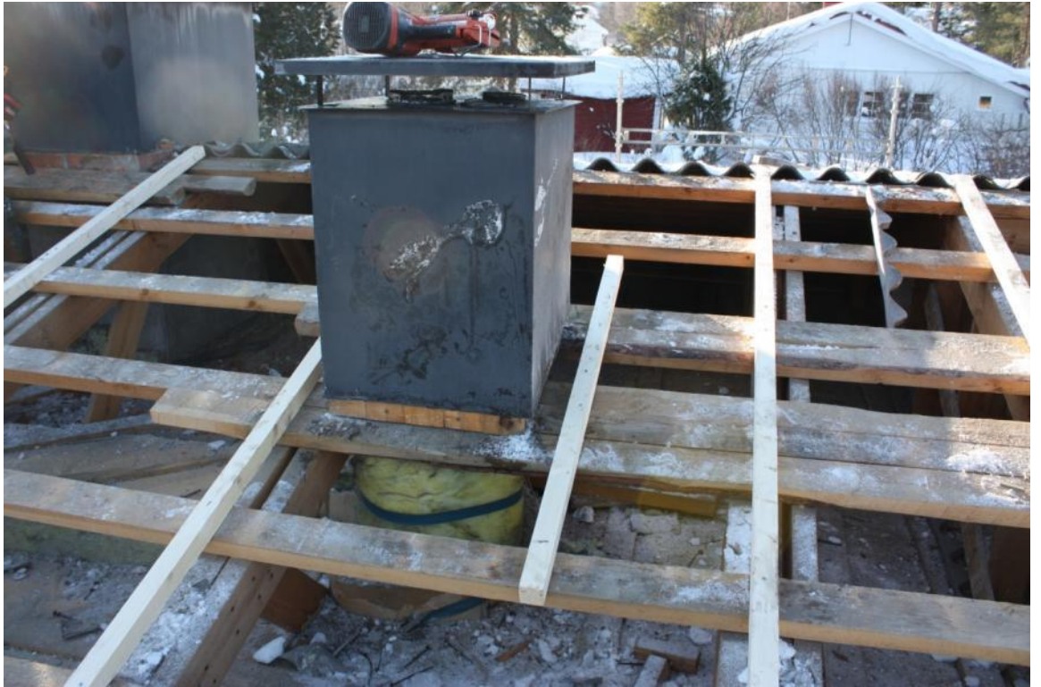
Kuva 14. Läpiviennin vierustan rimoitus.
