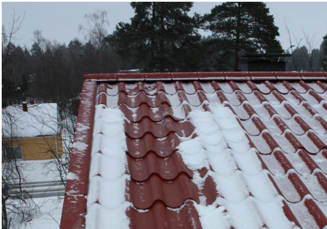
Kuva 31. Pääty- ja muotoharjalista oikein asennettuina.
