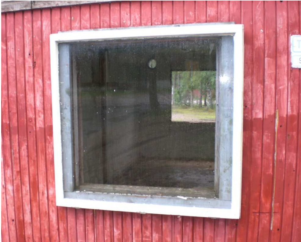
Kuva 14: Yksinkertainen ikkuna ehjänä
