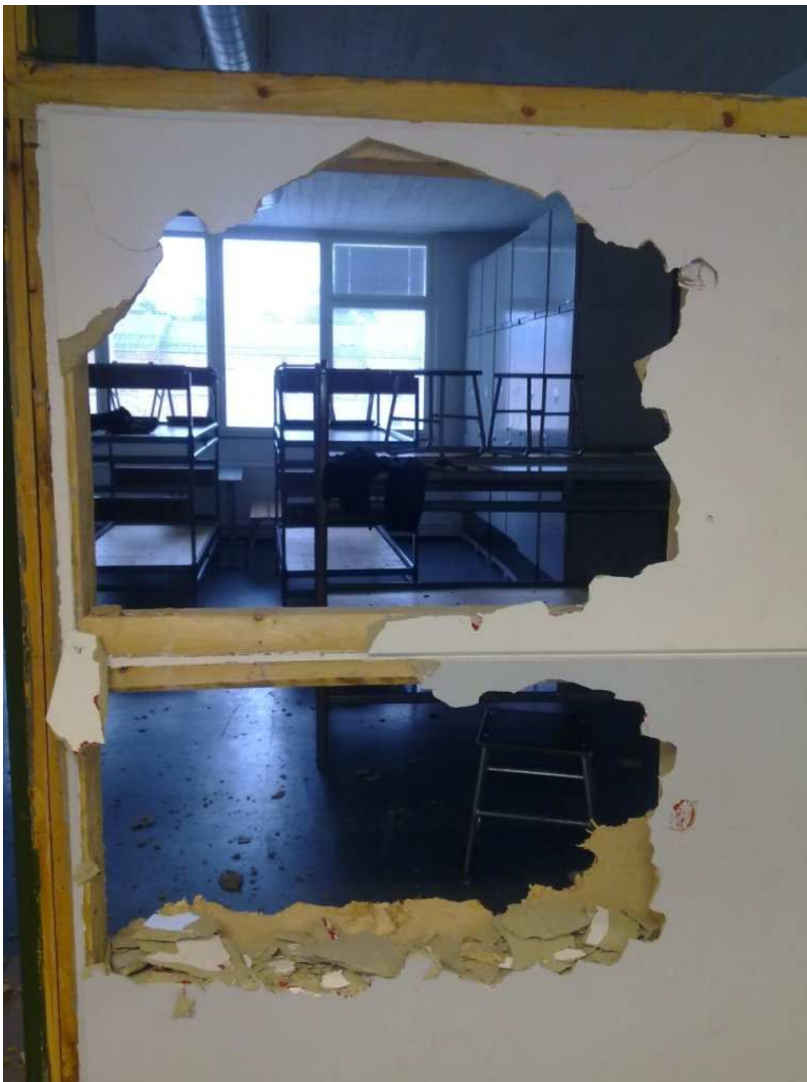
Kuva 4: Kevyt sisäseinä vasaralla tunkeutumisen jäljiltä
