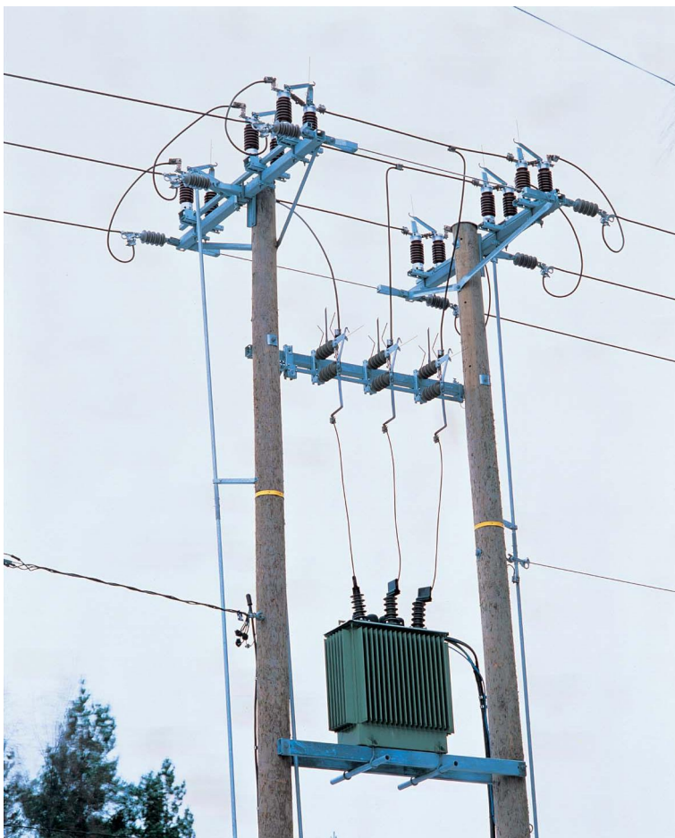
Kuva 7. NPS1 -erotin asennettuna sähköpylvääseen /6/
