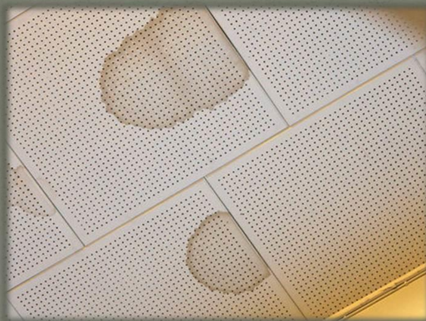
Tyypillisiä katto-/putkivuodon aiheuttamia läikkiä sisäkatossa.
