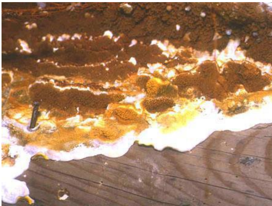
Kuva 9. Lattiasienikasvuston itiöemä hirressä. [8, s. 4.]
