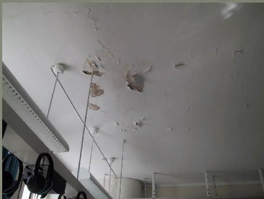
Kosteuden rapauttamaa maalia katossa
