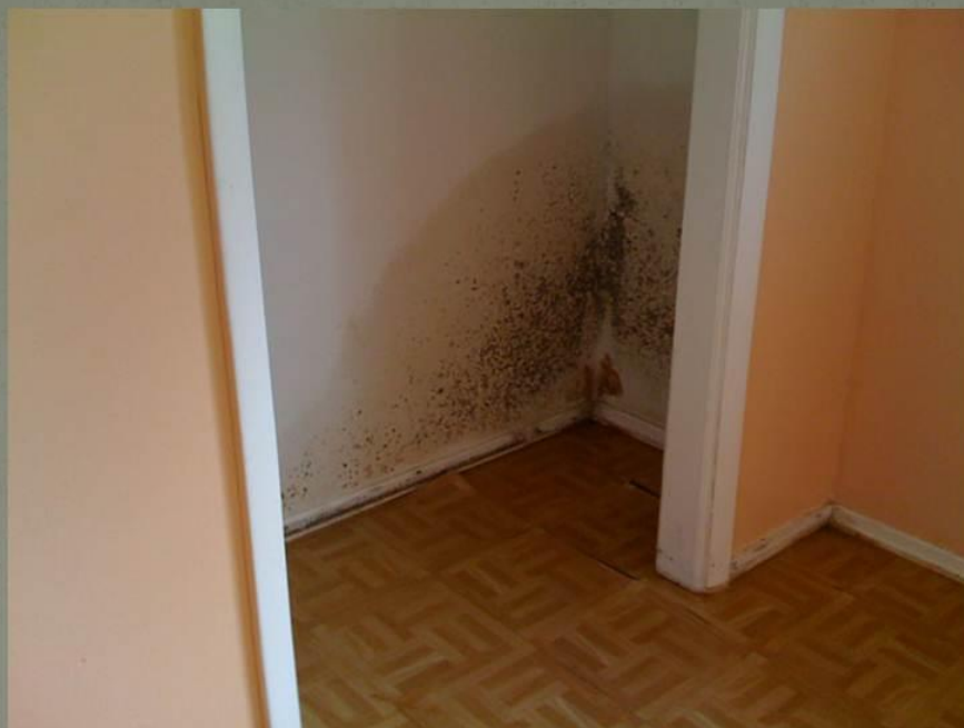
Kosteusvaurio seinässä ja lattiassa. Vaurio kasvaa jo näkyvää kasvustoa.
