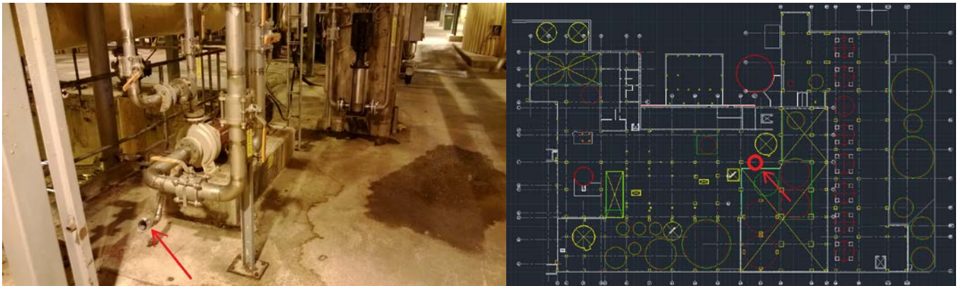
Prov 1 från tätningstvattnets tryckhöjningspump (0209009). Fiberlinjebyggnad 1 nivå +6.40.
