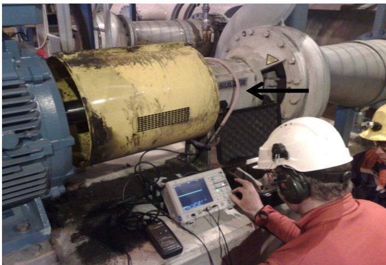
Kuva 47. Akselivirran mittaaminen Rogowskyn- kelalla pumpun akselilta.
