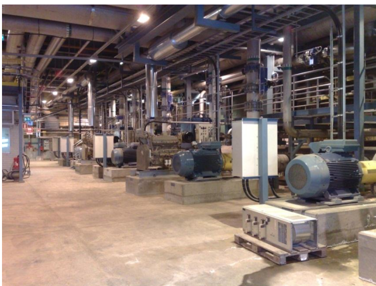
Kuva 3. JVL-2 sisältä, kuvassa kierrätyspumppujen moottorit.
