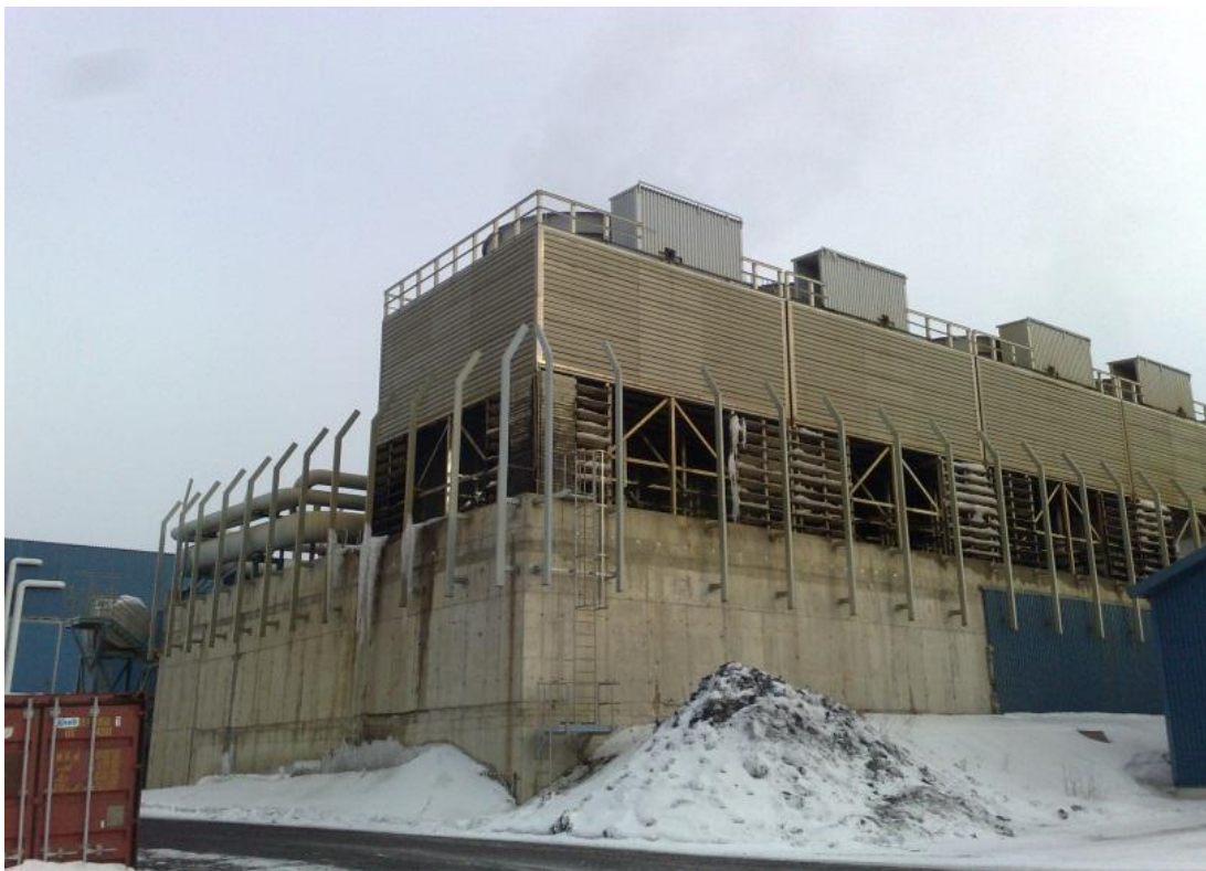
Kuva 4. JVL-2:n jäähdytystornit ja jäähdytysvesiallas
