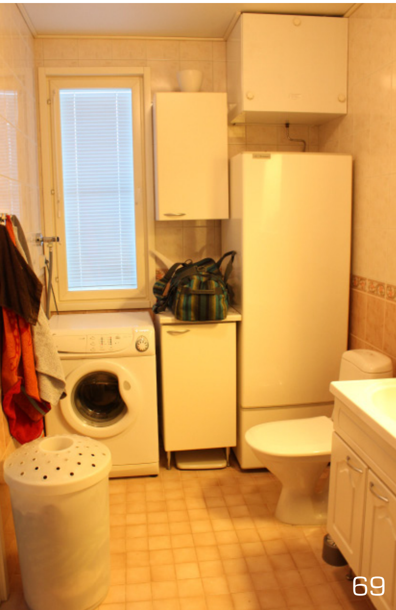
KUVA VESIBOILERI VIE PALJON TILAA NURKASSA, KAAPIIT VAIHDETAAN PITKÄKSI KAAPIKSI
