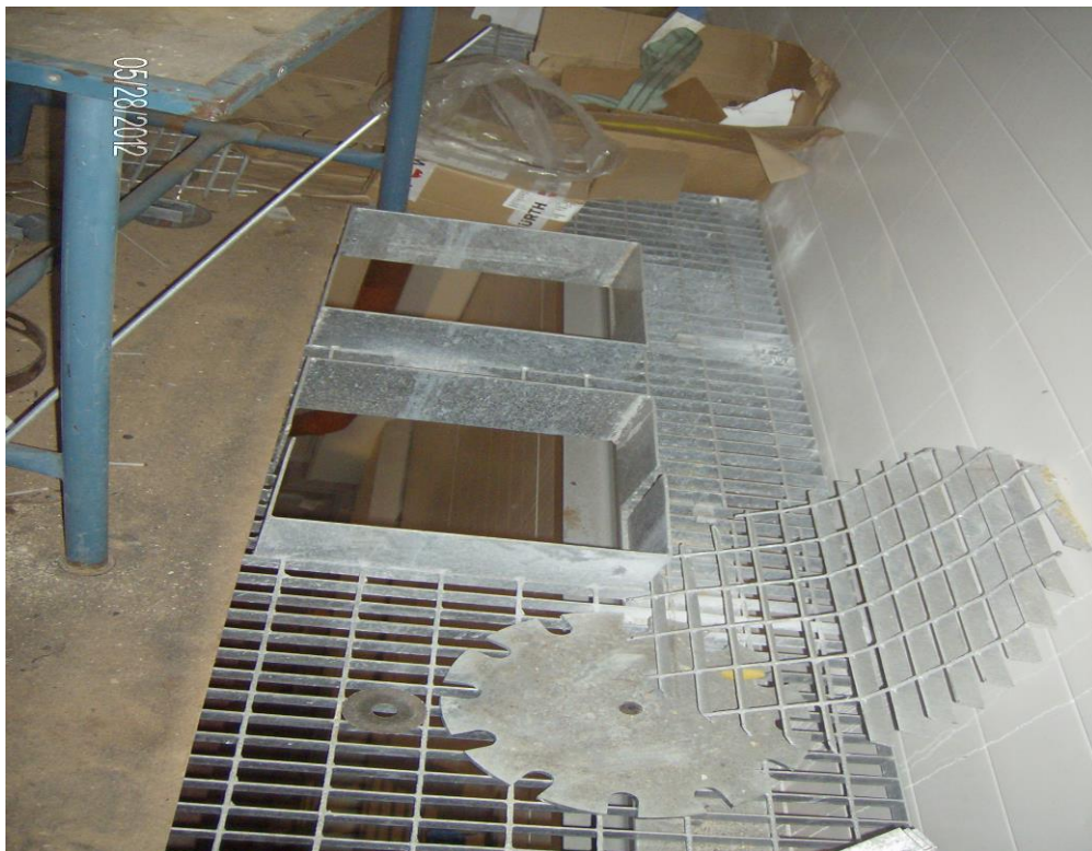
Kuva 4. Ritiävälipohja jossa on vaaraa aiheuttavat aukot [27]
