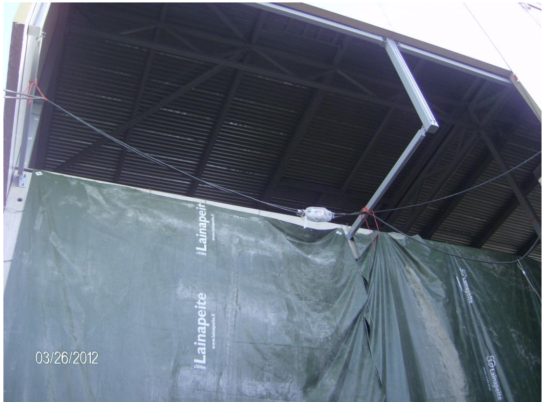
Kuva 18. Sähkökaapeli on sidottu oikeaoppisesti ylös [27]
