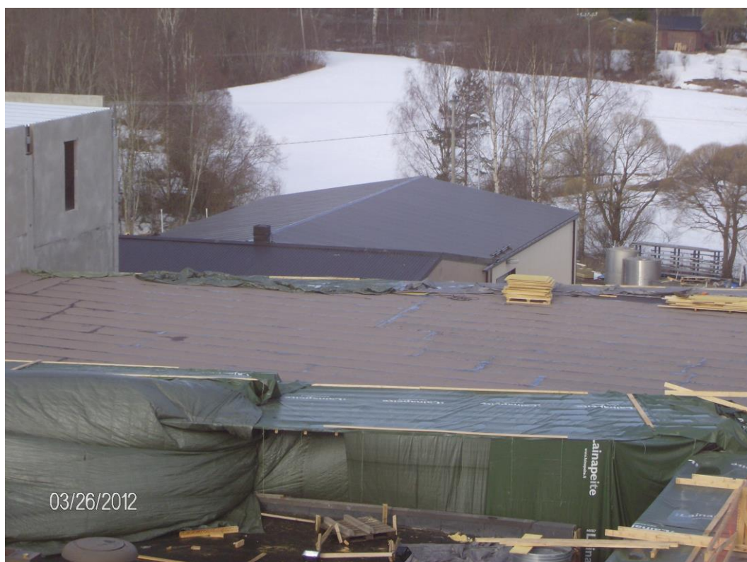
Kuva 2. Suojakatos estämässä esineiden putoamista [27]
