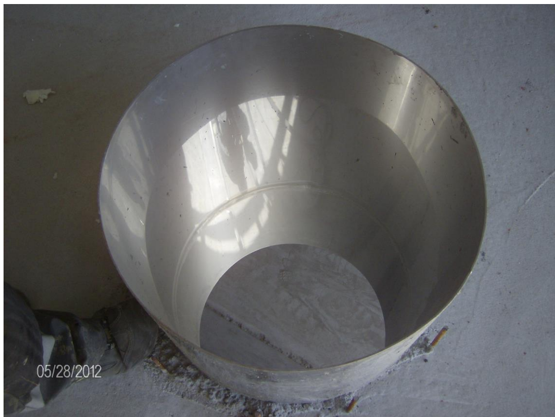
Kuva 17. Tavaroiden putoamissuojaukseksi aukko on peitettävä [27]
