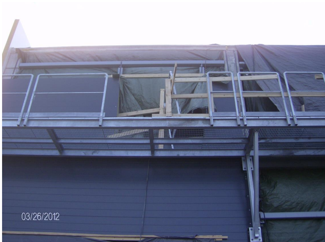
Kuva 16. Putoamissuojaus on poistettu tavaroiden nostoa varten [27]
