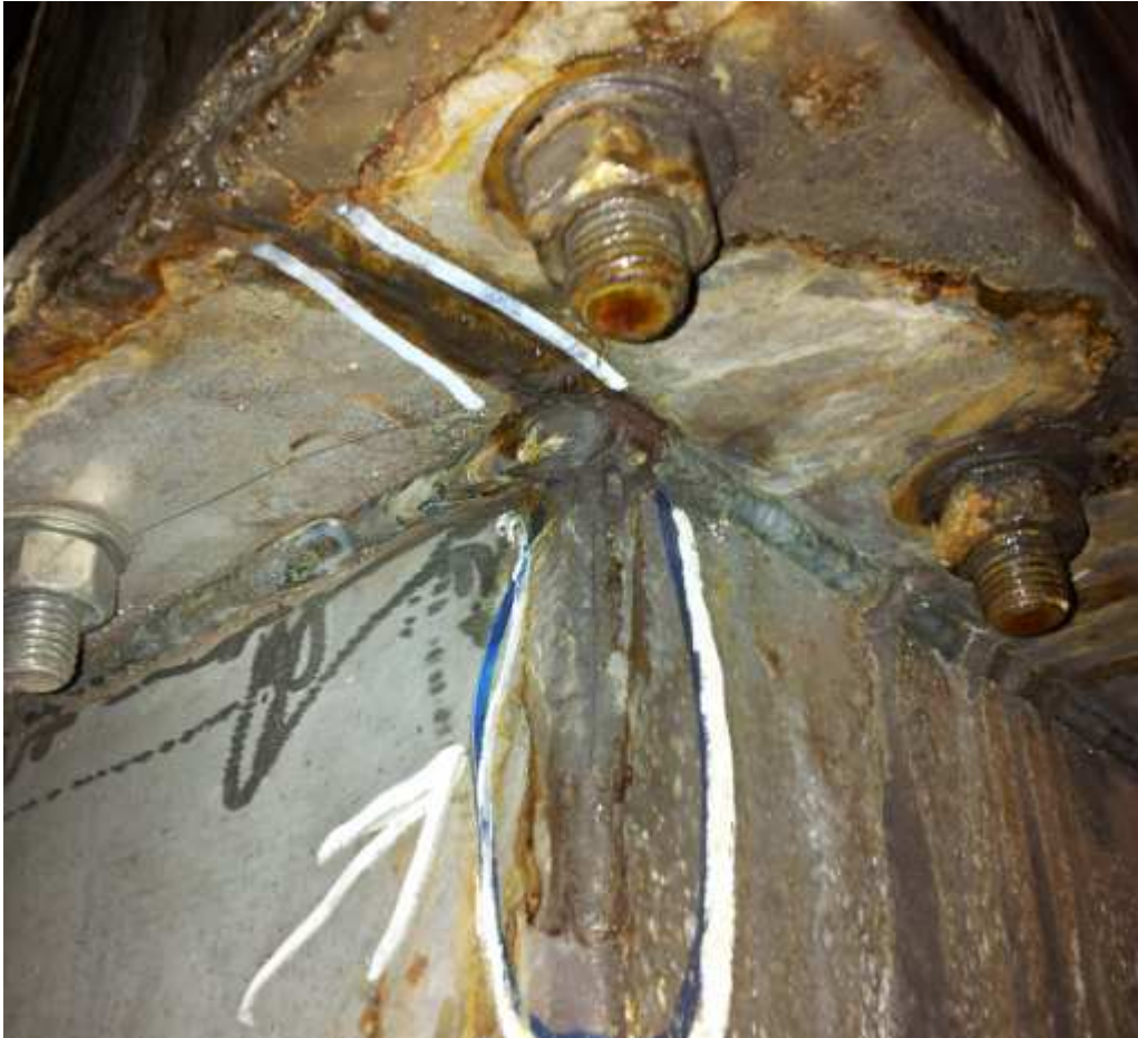
Kuva 15. Hitsaussaumassa oleva repeämä Rotoklon 1-puhaltimessa
