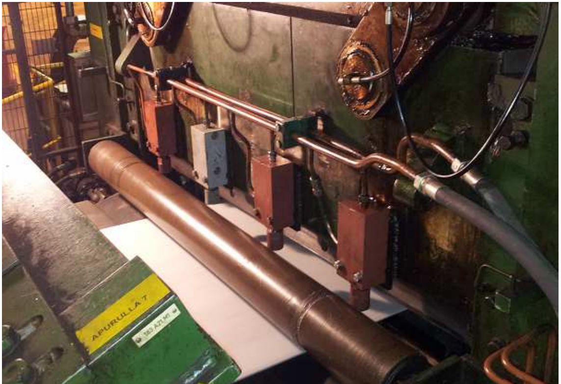
Kuva 12. Päätyleikkuri 3:lla olevat nauhanlukitussylinterit 4 kpl.
