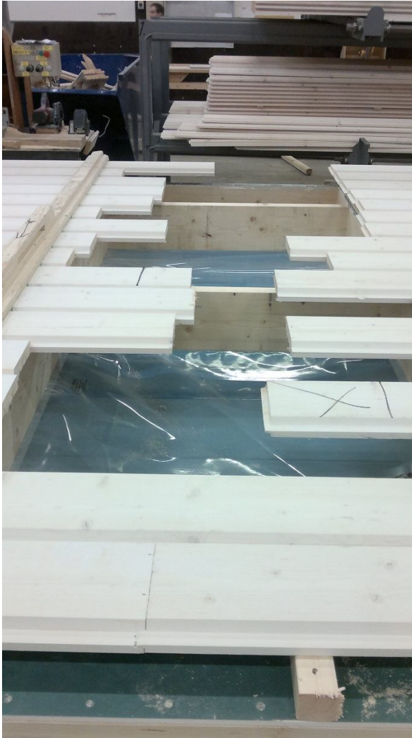
KUVA 7. Aukon päälle yltävät paneelien päät menevät pääsääntöisesti puutavarakonttiin
