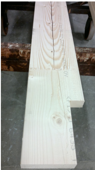
KUVA 8. Halkeama sormijatkotessa runkotolpassa
