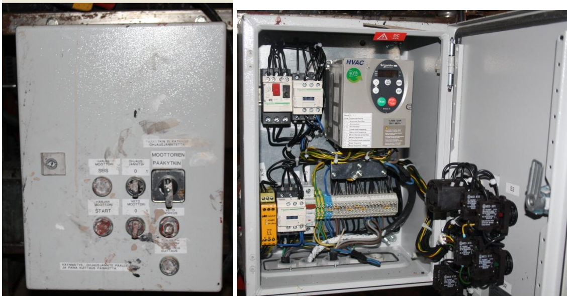
Kuva 19. Maalauslinjan ohjauspaneeli ulkoa ja sisältä.
