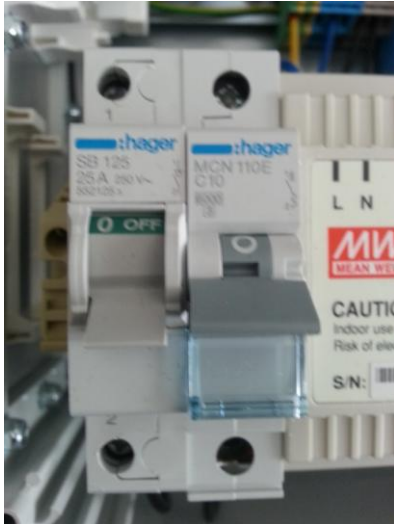
KUVA 1. Pääkytkin SB125 ja johdonsuojakatkaisija C10 (Kuva: Kare Rantanen 2013)
